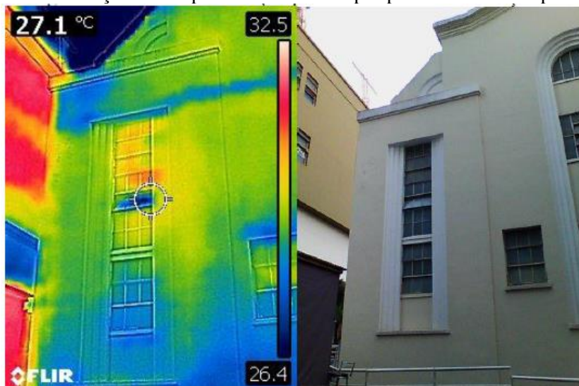
Figura 1 – Variação da temperatura observada por possível anomalia patológica
