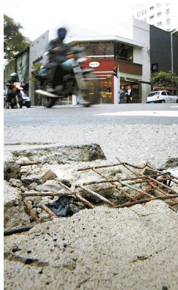
Figura 30 - Piso danificado na esquina das ruas Oscar Freire e Bela Cintra após cinco meses de reforma.
