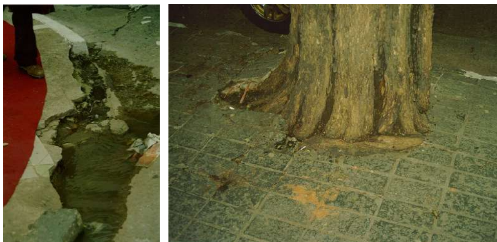
Figura 28 - Condição do pavimento na Rua Oscar Freire.
