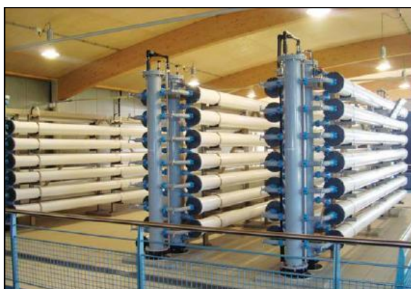
FIGURA 10: Sistema de Ultra-Filtração. FONTE: REVISTA MEIO FILTRANTE (s.d.).
