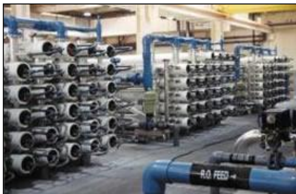
FIGURA 9: Sistema de Micro-Filtração. FONTE: TECNIUM (s.d.).
