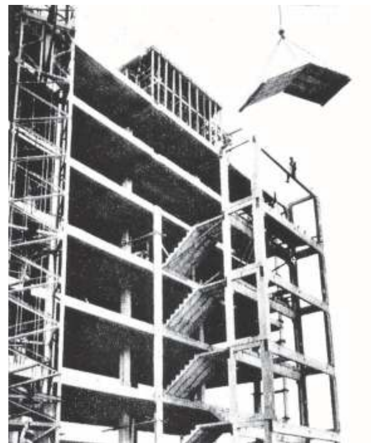
Figura 391: Detalhe da fase de montagem da estrutura pré-fabricada. Fonte: Revista do Diretório Acadêmico da Faculdade de Arquitetura Mackenzie, s/d, nº. 1, p. 47.
