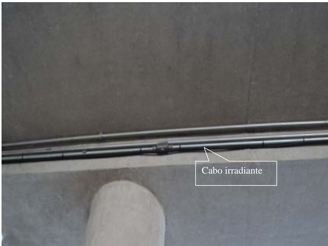
Fotografia 4 — Cabo irradiante instalado no hall do prédio T.
