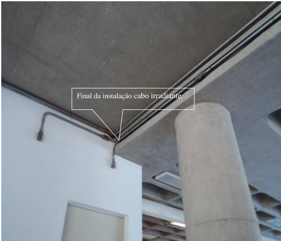
Fotografia 5 — Final da instalação do cabo irradiante, atrás do pilar fica a lanchonete.
