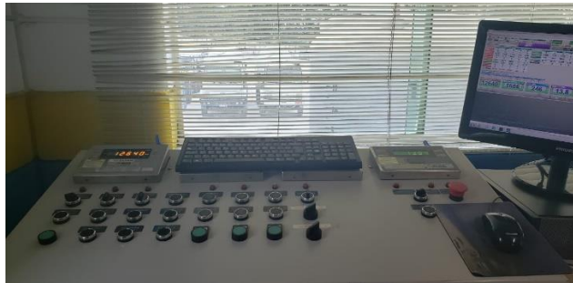
Figura 11 – Painel de Controle de Dosagem de Concreto Fonte: Autor, 2019
