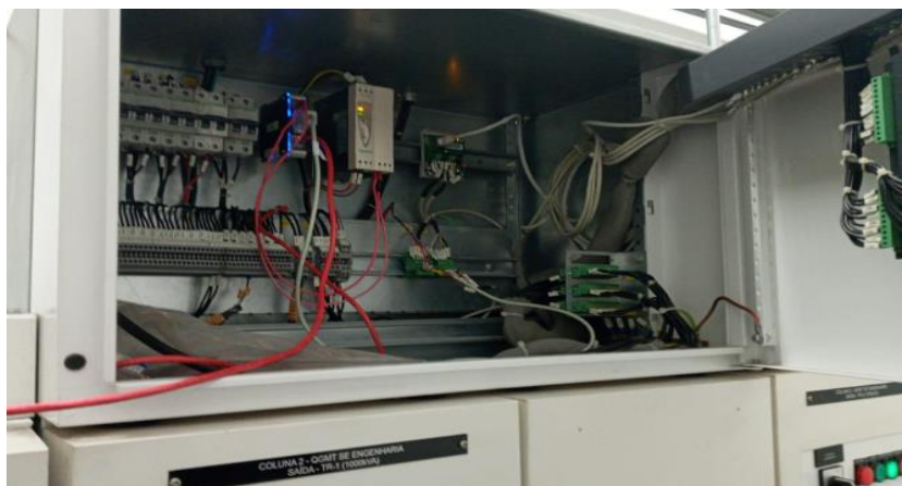
Figura 12 - Gateway ModBus instalado no Cubículo de 21 kV
