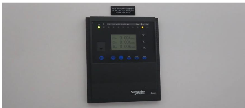
Figura 13 - Relé de Proteção Sepam S20
