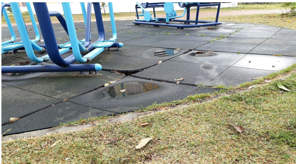
Figura 34: Área de lazer comprometido por falta de manutenção - conjunto habitacional Heliópolis I.
