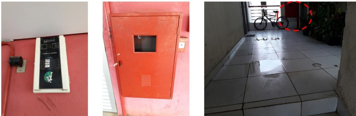
Imagens 35, 36 e 37: Sistema de combate a incêndio - conjunto habitacional Heliópolis I.
