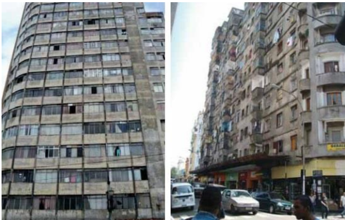
Figura 5: Imagens de dois edifícios em “mau estado de conservação” (PMSP, 2011e)
