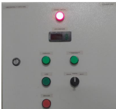
Fotografia 13: Painel de controle das condições da câmara úmida.
