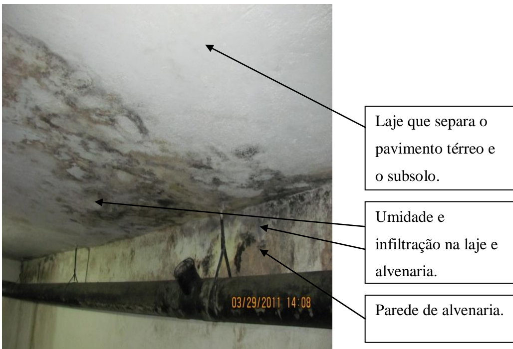
Fotografia 12- Umidade e Infiltração.
