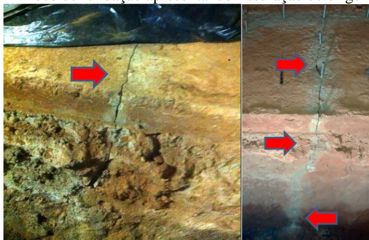
Figura 2 – Bloco de fundação apresentando fissuração de origem térmica.
