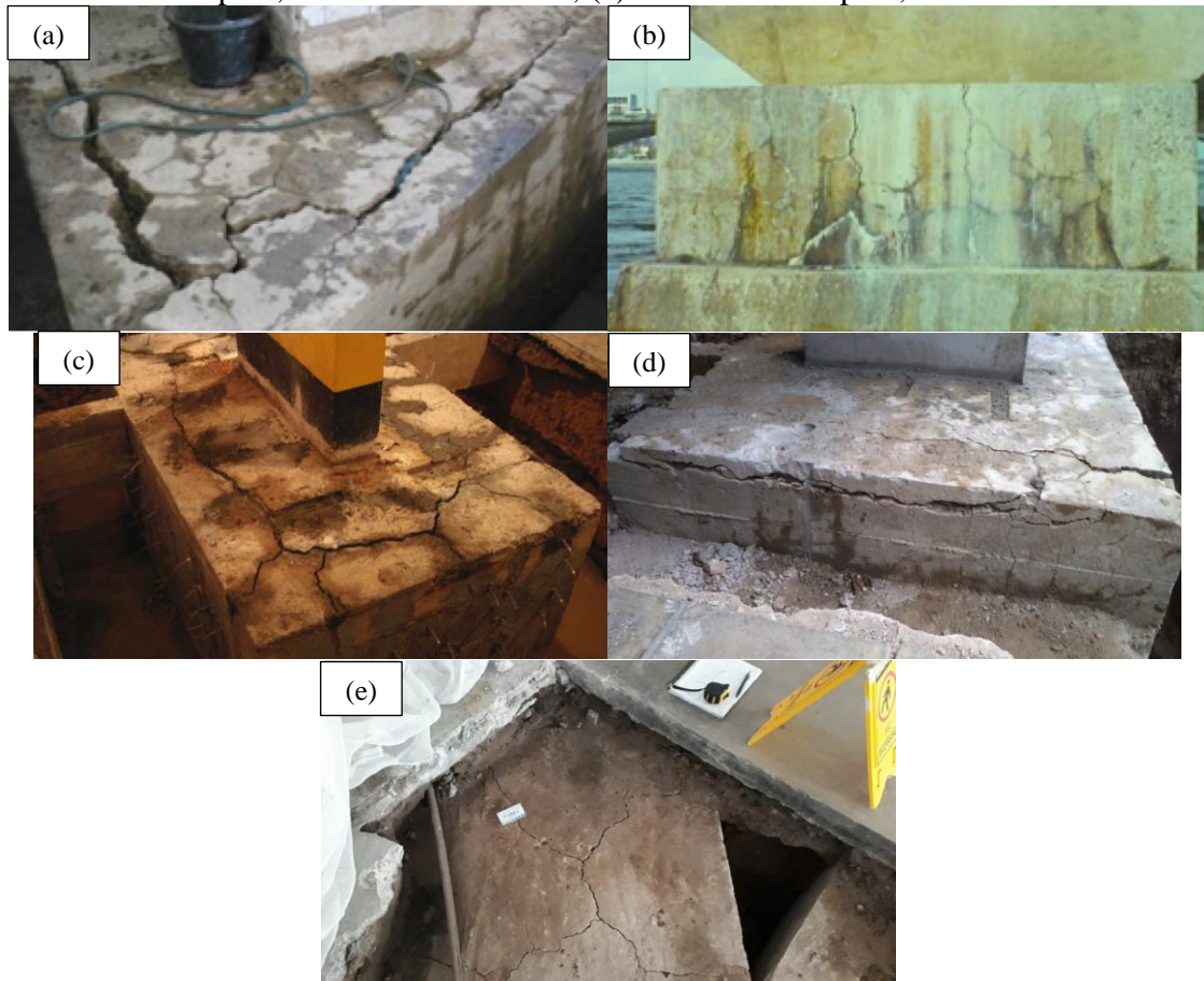
Figura 5 – Blocos de fundação e coroamento fissurados. (a) Edifício de 30 pav., descoberto em 2011; (b) Ponte Paulo Guerra, descoberto em 2001; (c) Edifício de 28 pav., descoberto em 2005; (d) Edifício de 32 pav., descoberto em 2013; (e) Edifício de 26 pav., descoberto em 2018.
