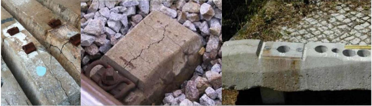
Figura 4 – Dormentes fissurados devido a DEF.
