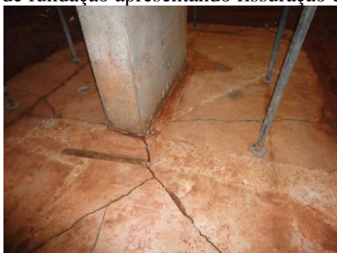
Figura 1 – Bloco de fundação apresentando fissuração de origem térmica.
