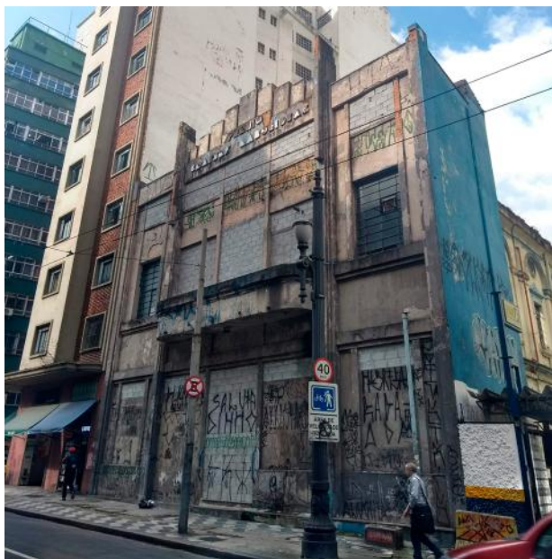
Figura 1: Foto do edifício em questão e seu estado atual | Foto tirada por Laís Paraizo, Outubro de 2018.
