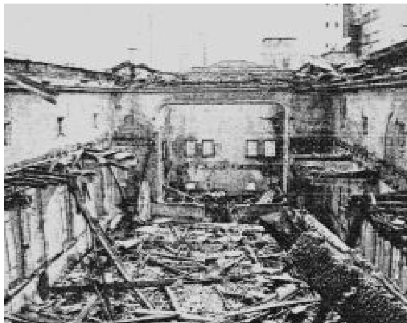
Figura 34: Fotos da visita técnica pós incêndio, 2008. I nº 27943/CONDEPHAAT/90; p. 174.
